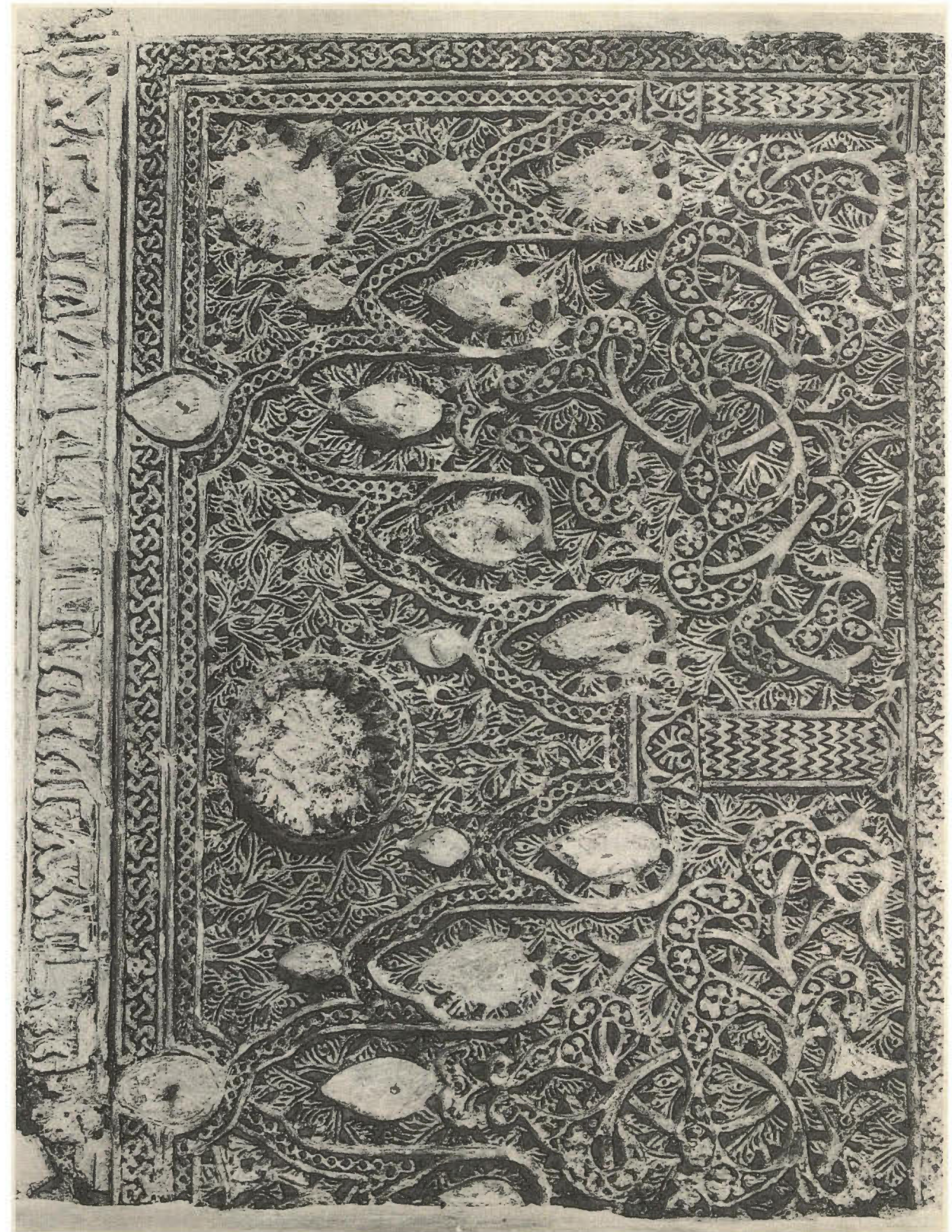
Yesería del friso en la galería alta de comunicación con las tribunas de la Sinagoga de "El Tránsito,,
