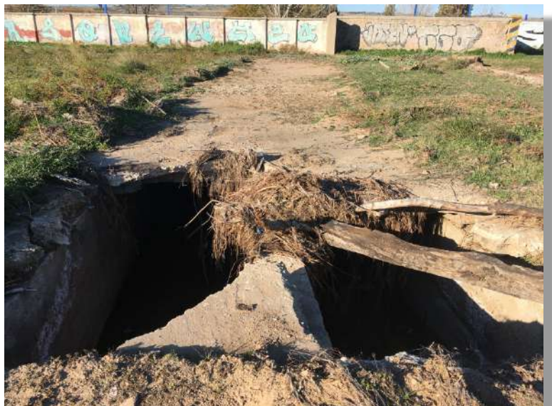
Vistas del cauce artificial existente en estado derruido:
